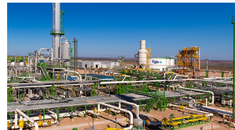
Planta Compresora Tratayén
