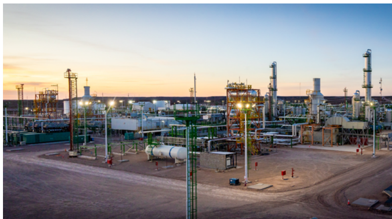
Planta Compresora Tratayén.
